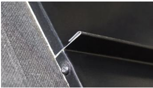
A. Notera falsomslag på takplåt.
